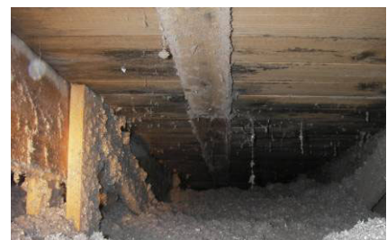
Bild 15. Efter ett par år har skadorna blivit mer omfattande och utbyte av delar av underlagstaket kan bli aktuellt.
