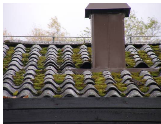
Bild 6. Hur ser det ut under takpannorna? Är underlagspappen hel? Hur lång tid är det tills den skall bytas?
