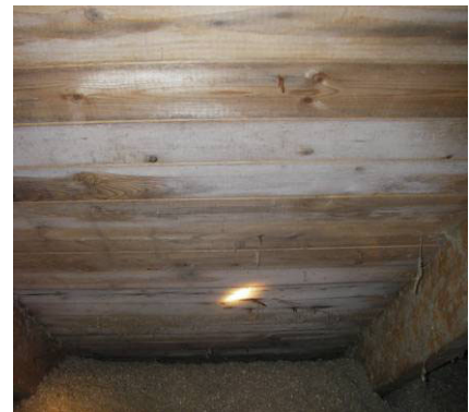
Bild 14. Missfärgningar som uppkommit efter tilläggsisolering. Upptäcks fuktutfällningen tidigt kan åtgärder göras utan att omfattande skador hinner uppstå. Primärorsaken till skadan är ett otätt vindsbjälklag i kombination ett invändigt övertryck som innebär att fuktig inneluft tillförs vindsutrymmet.
