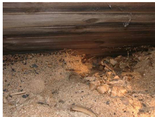
Bild 7. Tecken på uppträngande fuktig inomhusluft som kondenserar mot underlagstakets kalla yta.
