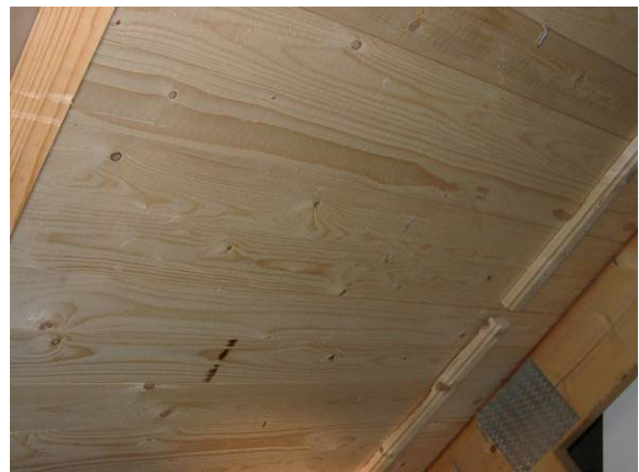
Bild 1 Ingen synlig påväxt men riklig påväxt enligt den mikrobiologiska analysen. Detta är normalt ingen skada - återkommande kontroll är alltid att rekommendera!
